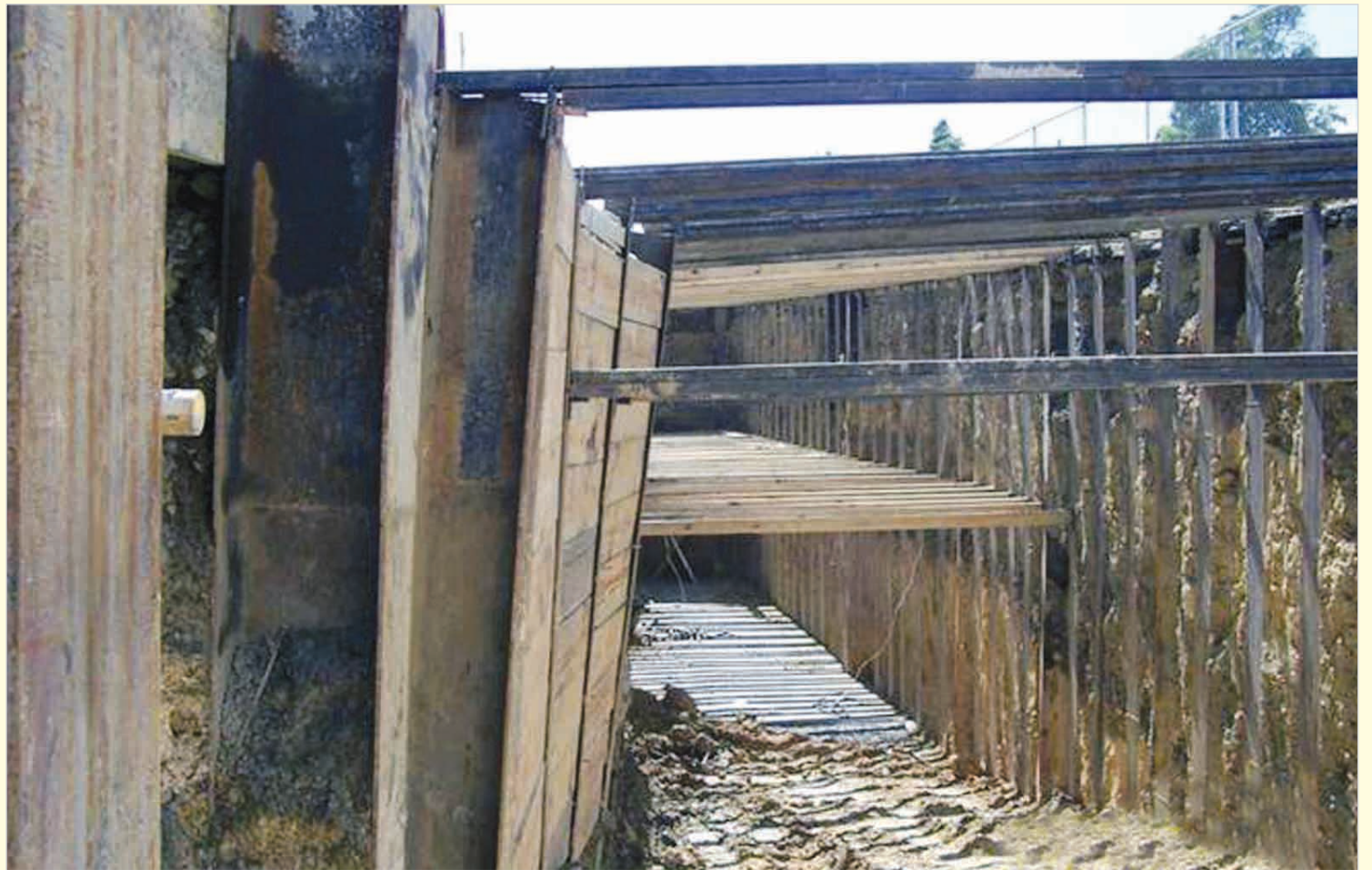
La falta de estudios previos ha obligado a soluciones improvisadas.
